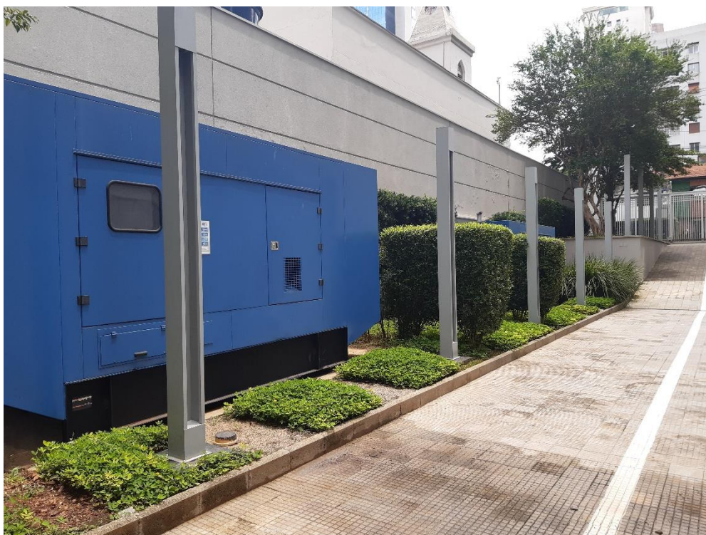
Área técnica – gerador
