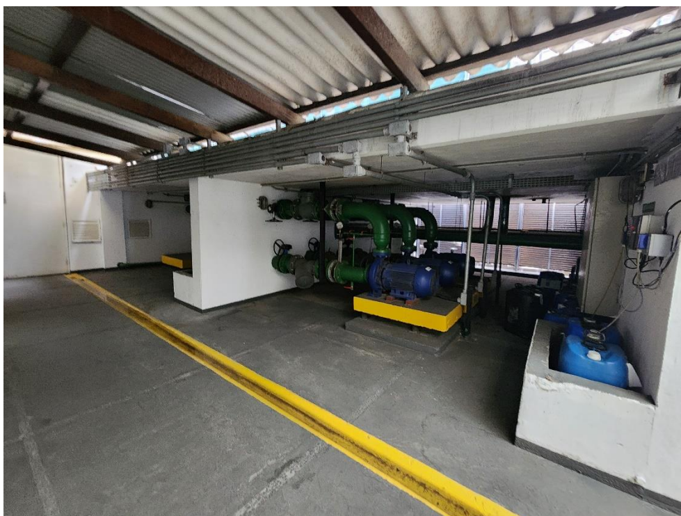
Casa de máquinas
